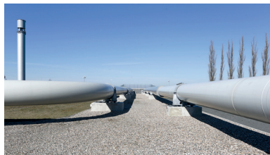
Мал. 172. Трубопровід Nord Stream на земній поверхні у Німеччині
